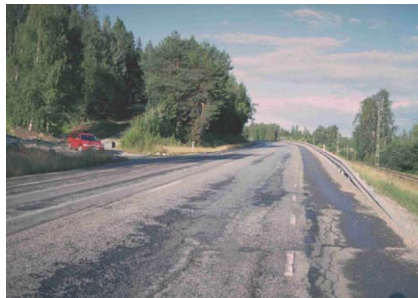
Sönderfallande beläggning på gamla E4, nuvarande väg 90, vid Gustavsvik.
